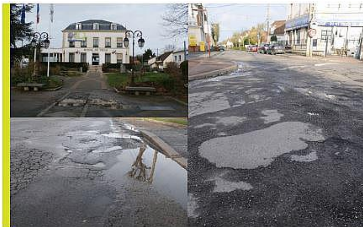
Etat désastreux de la voirie : des ornières dans les chaussées et sur les trottoirs, même devant la mairie !
